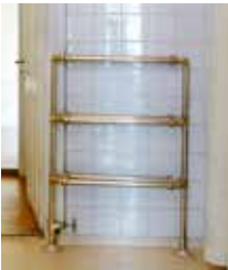
Handdukestorken i badrummet var tidigare kopplad till den vattenburna värmen.
